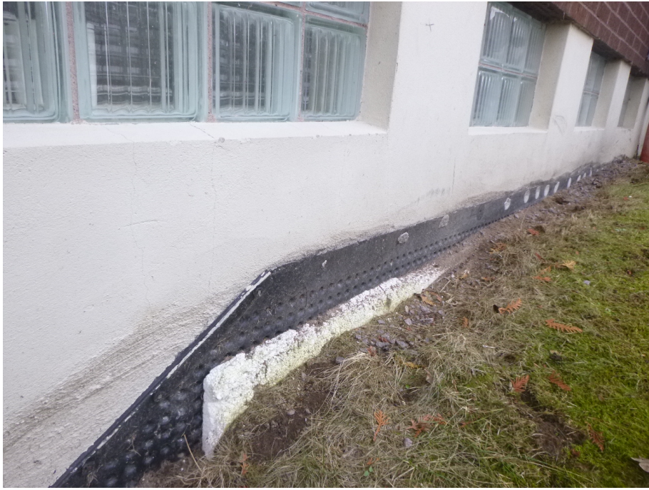
Fuktisoleringsmatta synlig ovan mark.
