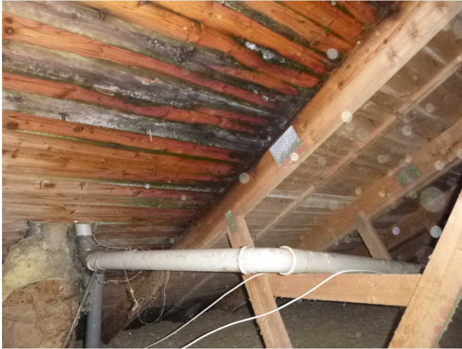
Mikrobiell påväxt underlagstak, vindsutrymme.
